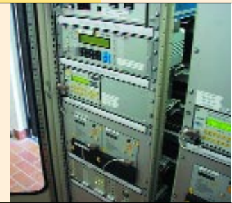
Schaltschrank mit Elster- und Flow Comp-Geräten bei Saarferngas
