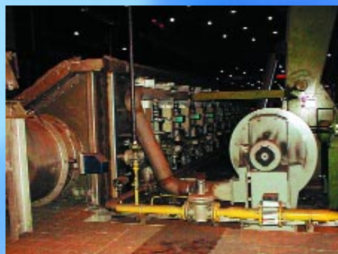
Eingangsmessung vor einer Ofenanlage
