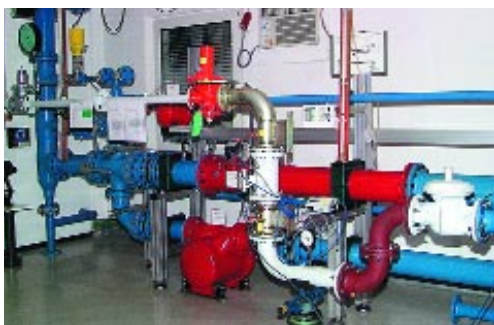
Abb. 1: Vertikal eingebauter TRZ G 250 DN 100 hinter einem Gasdruckregelgerät mit Rohrbogen
