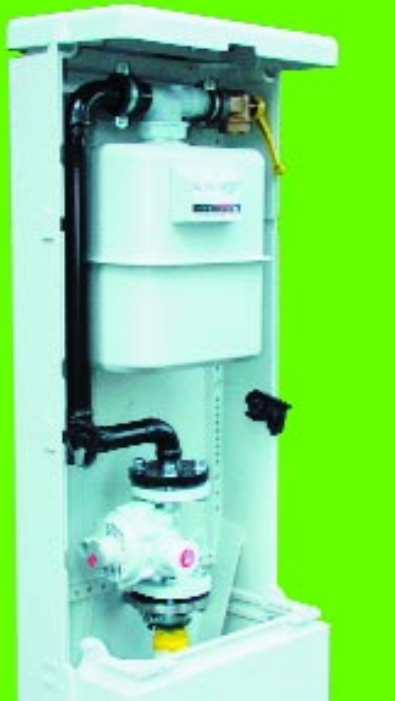
Hausanschlussschrank mit M2R
