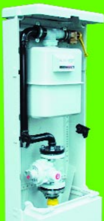
Hausanschlussschrank mit M2R
