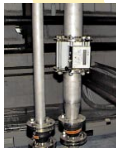
Messung eines BHKW's
