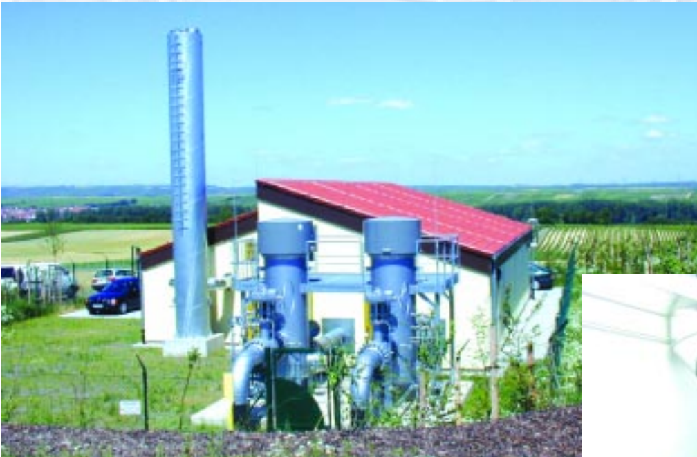
Mess- und Regelanlage Herrnsheim
