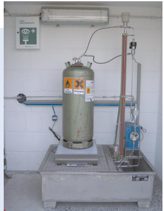
Abb. 1: Odorieranlage mit verwogenem 45 kg Gebinde
