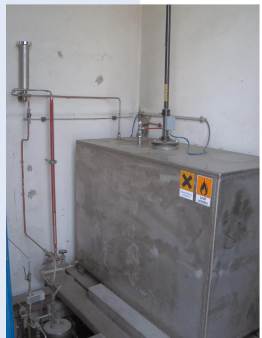
Abb. 2: Odorieranlage mittlerer Größe mit 800 l-Tank. Füllstandmessung über Magnetklappenanzeiger.
