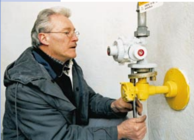
Abb. 2: Gaswerker Alois Schönberger sichert am Flansch den Gasdruckregler mit einer speziellen Verschraubung, einer passiven Sicherheitsmaßnahme, die in Roding getestet wird.
