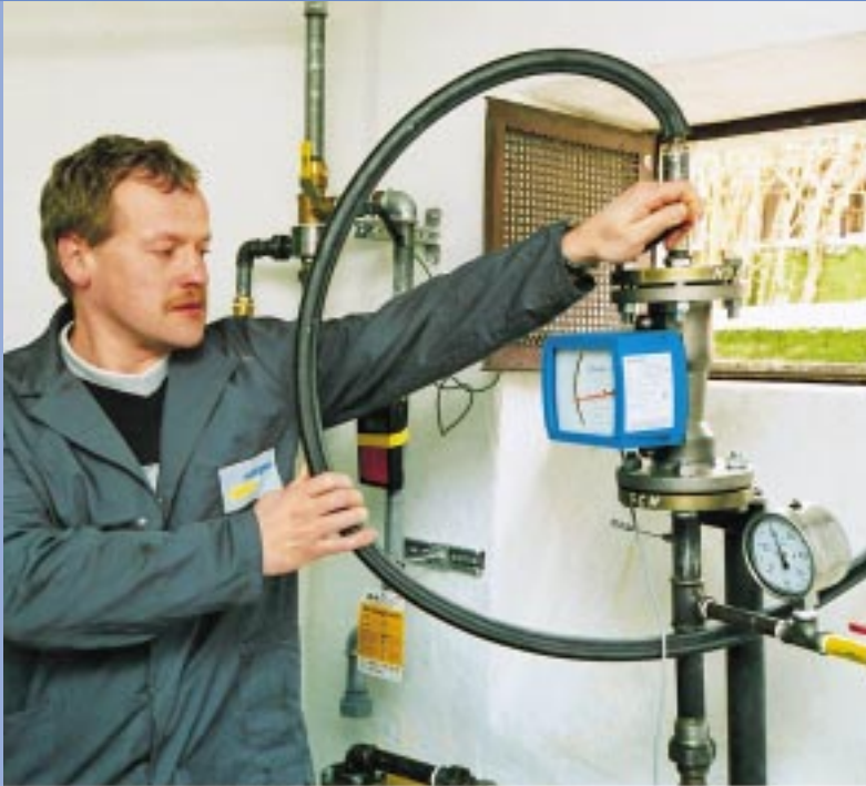
Abb. 5: Mit einer ausgefeilten Versuchsanlage prüft Gasmeister Steffen Reimann von der Betriebsstelle Roding die Leistungsfähigkeit des Gasströmungswächters in der Hausanschlussleitung.
