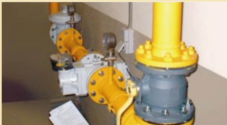
Installation ohne Impulsleitung
