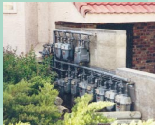
Hausanschlusswand? Gesehen in Kanada von D. Spingat, ESWE Wiesbaden
