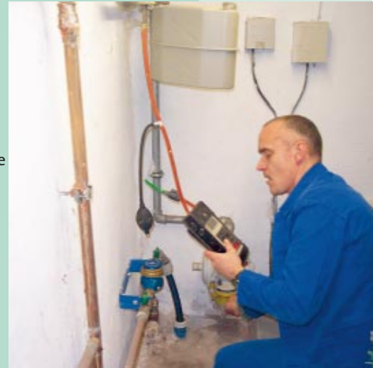
Wartung und Instandhaltung Hausanschluss: Der Monteur von NGT prüft die Reglerfunktion
