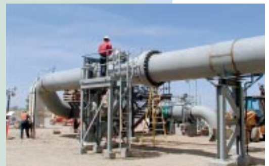
Abb. 3: Mehrpfadzähler DN1050 der Typenreihe Q.Sonic in der Ausgangsleitung eines Zentrifugalverdichters von Pacific Gas in den USA
