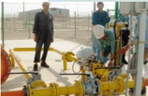
Abb. 2: Neuer U-förmiger Messaufbau für den Einbau eines DN100 Q.Sonic USZ in den Vereinigten Arabischen Emiraten
