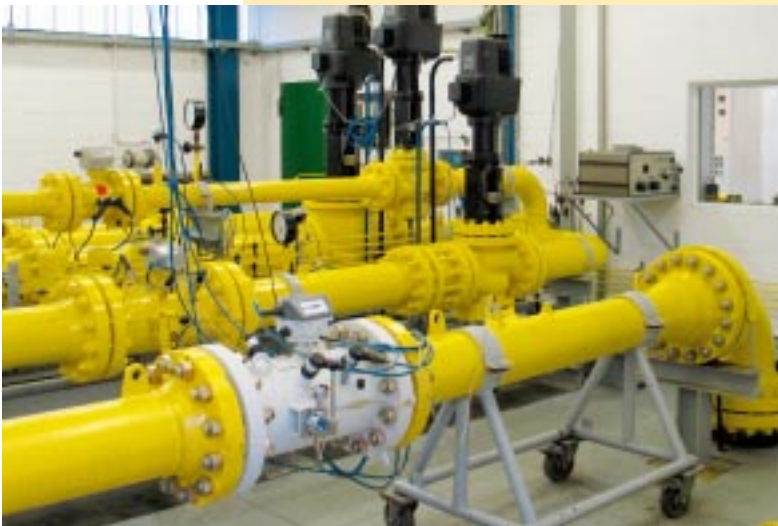
Im Vordergrund ein TRZ-Prüfling, im hinteren Bereich Gebrauchsnormale mit Ein- und Auslaufstrecken
