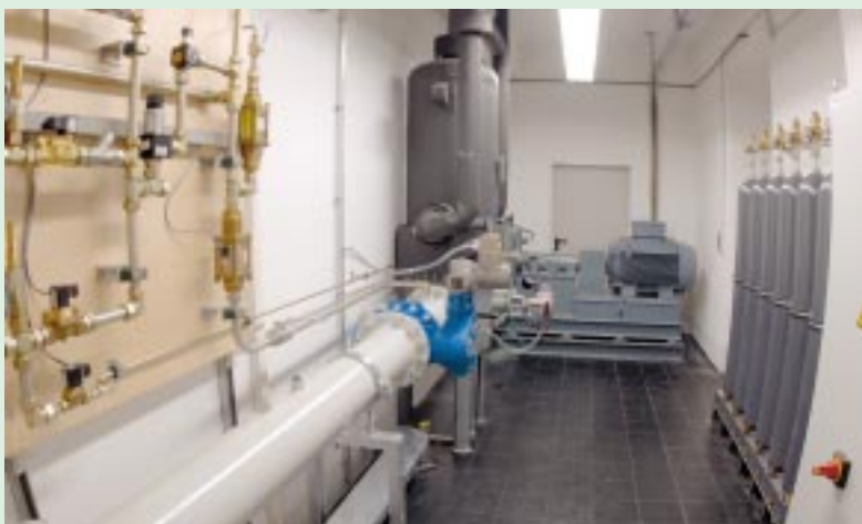
Abb. 3: Technikraum mit Hochdruckgebläse
