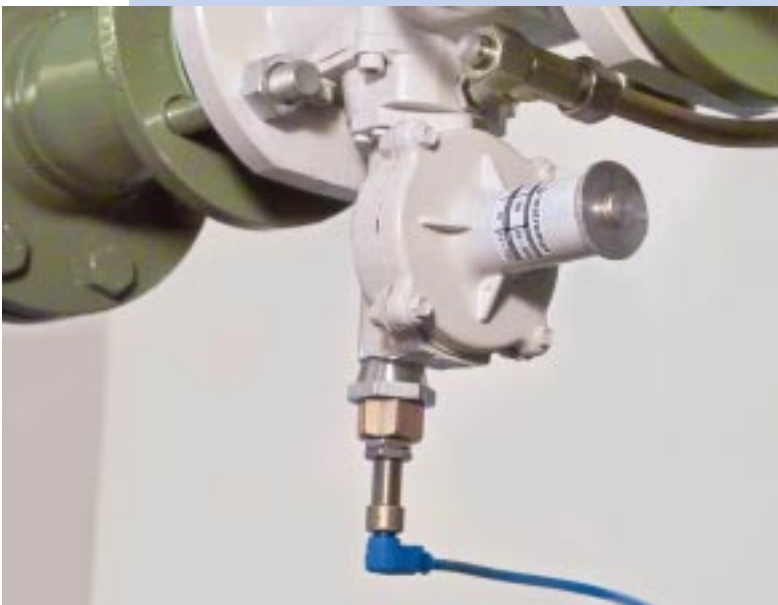
Gasdruckregelgerät mit SAV-Fernabfrage
