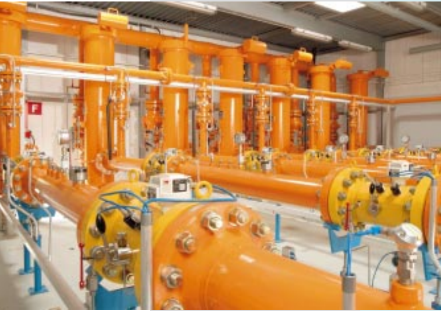
Blick in den Gasmessraum
