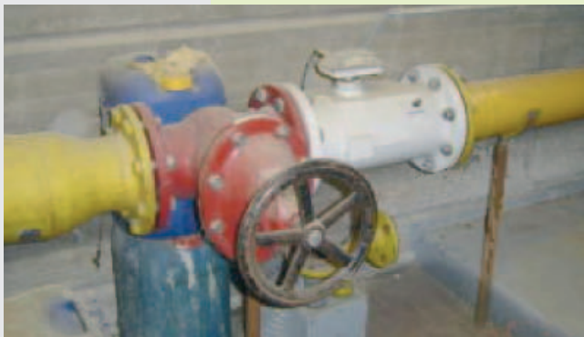
Alte Messstrecke Krankenhaus
