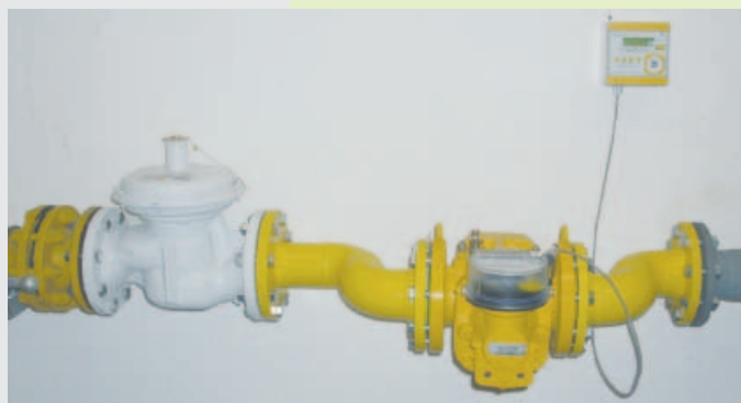
Neue Mess- und Regelanlage im Hotel „Leininger Hof“
