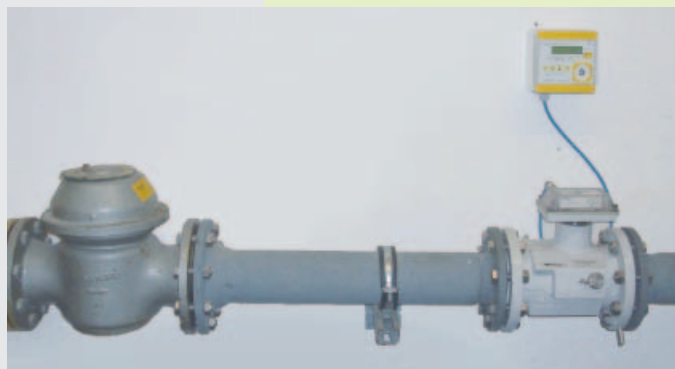
Alte Mess- und Regelanlage im Hotel „Leininger Hof“
