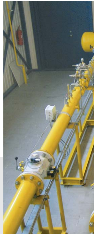
Gasmess- und Gasregelstation des Kraftwerks IRU
