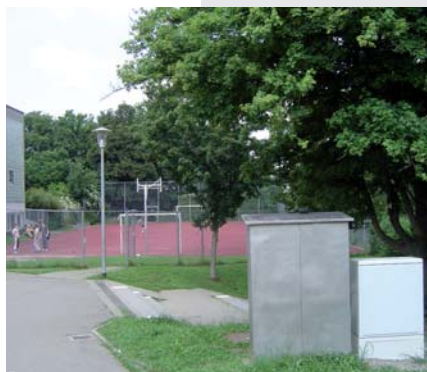
Abb. 1: Gasstation in unmittelbarer Nähe einer Straßenlampe
