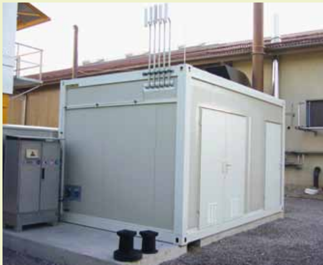
Abb. 3: Container mit der Biogas-Einspeiseanlage bestehend aus Konditionierung, Odorierung und amtlicher Volumen-, und Gasbeschaffenheitsmessung
