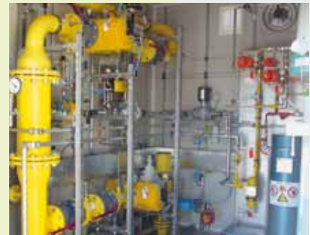
Abb. 5: Volumenmessanlage und LPG-Konditionierstrecke
