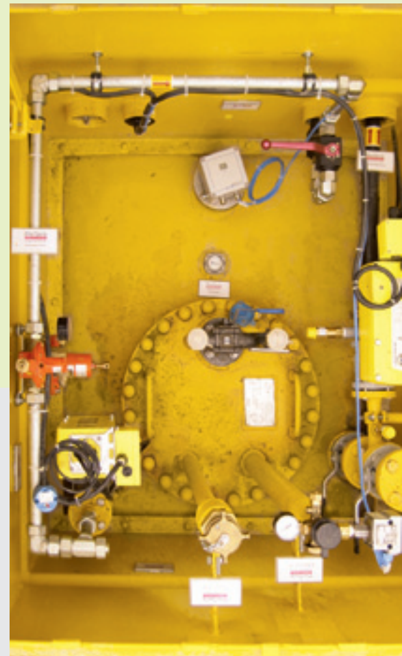
Domschacht BGEA Altenstadt
