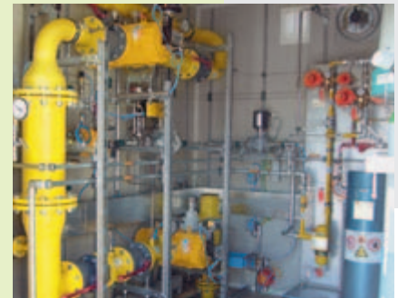
Abb. 5: Volumenmessanlage und LPG-Konditionierstrecke
