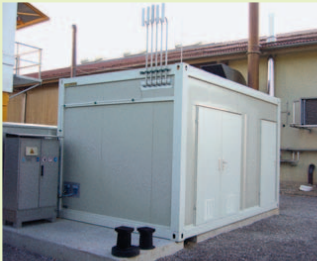
Abb. 3: Container mit der Biogas-Einspeiseanlage bestehend aus Konditionierung, Odorierung und amtlicher Volumen-, und Gasbeschaffenheitsmessung
