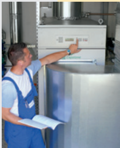
Mikrogasturbine in der GDRM-Anlage
