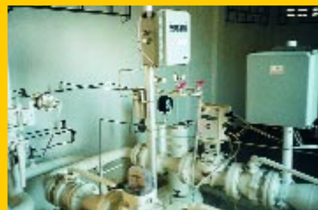
Fig. 2: American Meter GT turbine meters and a dual-run AE5000 volume corrector at a city gate station supplying gas to Gases del Caribe, Barranquilla Medidores de turbina GT y corrector de volumen modelo AE5000 de doble corriente en una estación de portal de ciudad que suministra gas a Gases del Caribe, de Barranquilla
