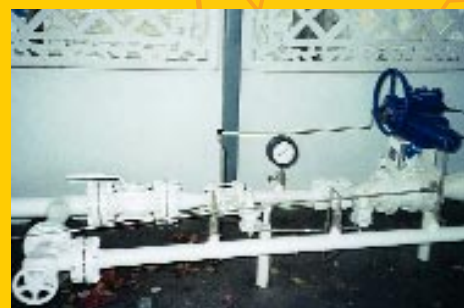
Fig. 1: American Meter Axial Flow Valves at a city gate station supplying gas to Gases del Caribe, Barranquilla Válvulas de flujo axial de American Meter en una estación portal de ciudad que suministra gas a Gases del Caribe, de Barranquilla
