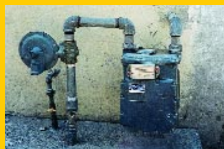
Fig. 5 : American Meter AL-425 (12 cubic meter an hour) diaphragm meter and 1813C regulator at a commercial site in Barranquilla Medidor de diafragma modelo AL-425 (con capacidad de 12 metros cúbicos por hora) y el regulador 1813C de American Meter en una planta comercial en Barranquilla
