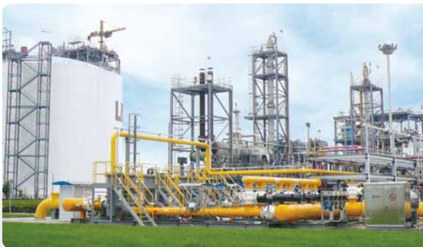
Shanghai LNG Peak Shaving Project
